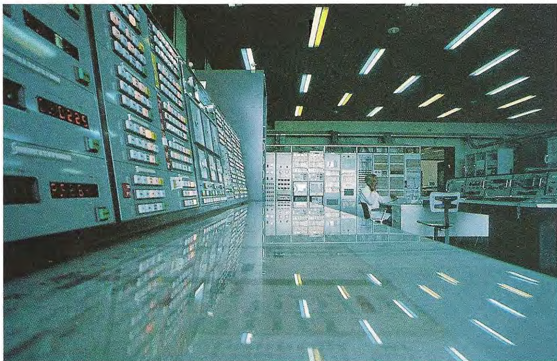
Une vue impressionnante des installations d'une salle de commandes.
